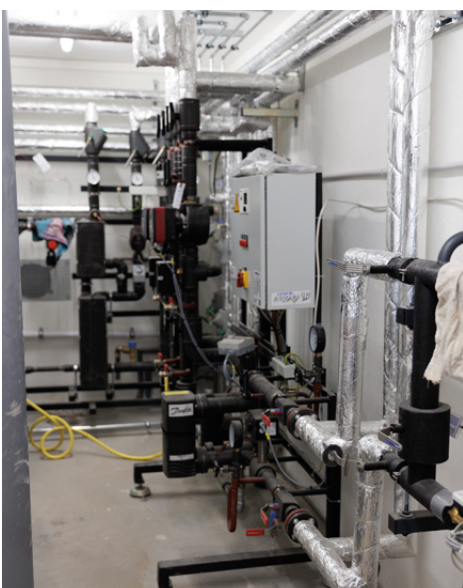
Die Herzkammer des Gebäudes. Hier werden Strom, Klima, Internet und Fernwärme gesteuert.
