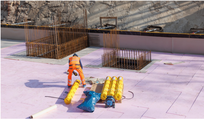
Das Auftragen der 14 cm dicken Dämmschicht. Darauf wurde eine 80 cm starke Betonsohle gegossen
