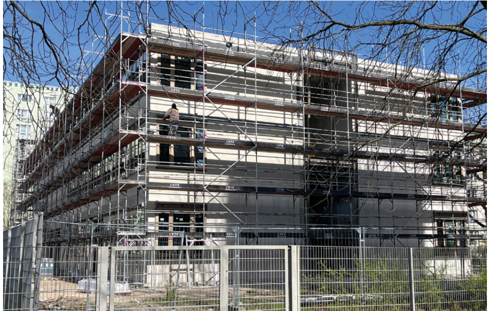
In den gesamten Schul-Campus »Charlotte-Pfeffer-Schule« werden insgesamt 33 Millionen Euro investiert. Der neue Ergänzungsbau gehört dazu.
