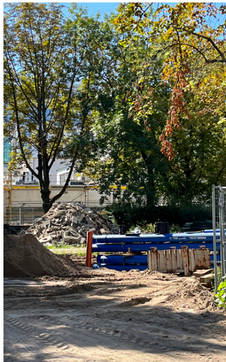
Wegen eines Wasserrohrbruchs müssen die Bauarbeiten für den inklusiven Spielplatz an der Mollstraße 15–18 ruhen.
