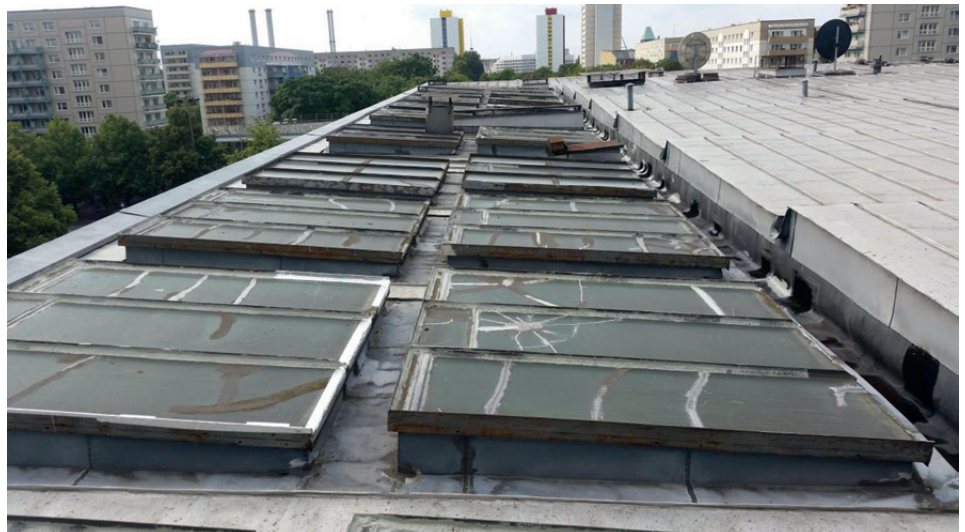
Die Oberlichter sind stark beschädigt und wurden schon mehrfach notdürftig geflickt. Ab Frühjahr 2024 wird hier saniert.
