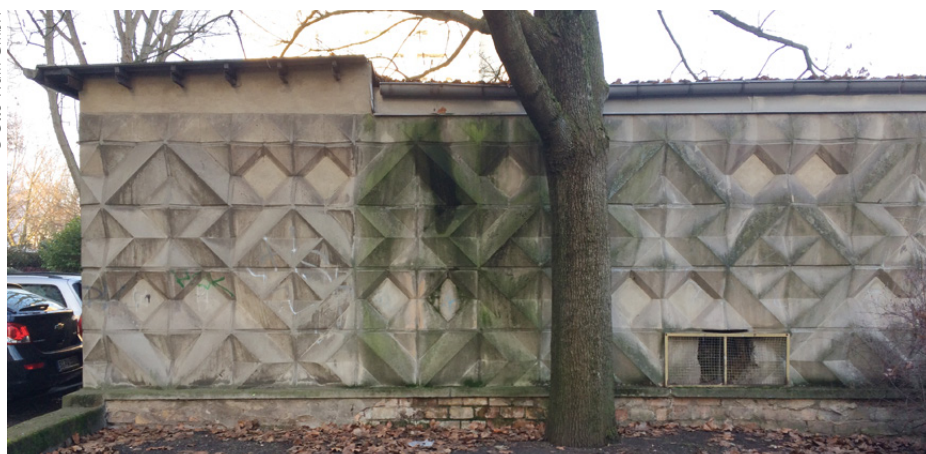
Die Struktur-Mauer vor der Sanierung.
